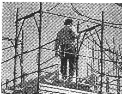
Le cadute dai ponteggi sono tra le prime cause di morte nei cantieri
